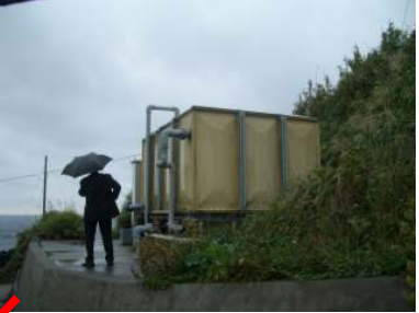
貯水タンク 30トン
